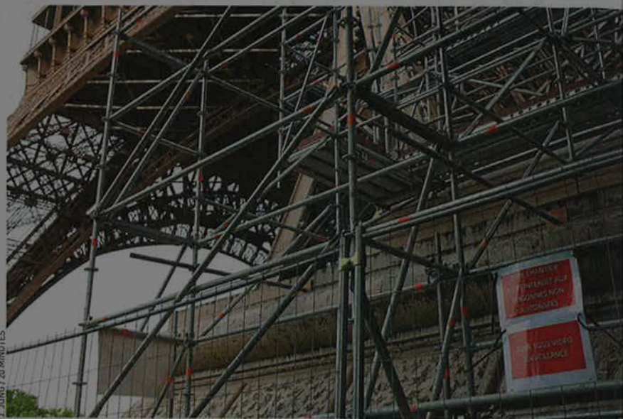
L'accès à l'échafaudage du pilier ouest de la tour Eiffel était mal fermé, selon la police.
